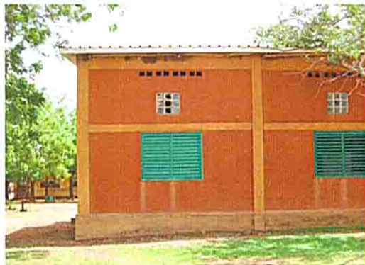
割れたガラスブロック窓
