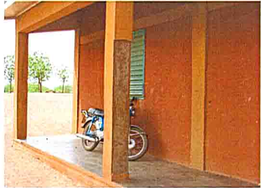
モルタルが剥離した外廊下の柱
