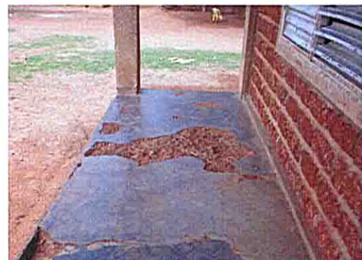
床が剥離している外廊下
