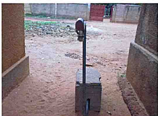
給水設備（水栓に鍵がかかっている）
