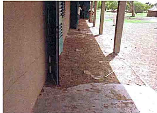
外廊下の床が剥離
