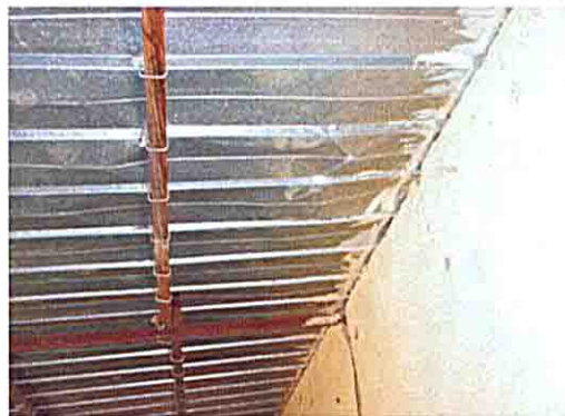
ゆがんでいる屋根材
