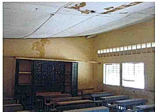
教室内部 (天井は少し傷んでいるが通気性がよい)
