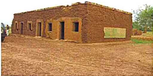
教室棟外観（老朽化が激しい）
