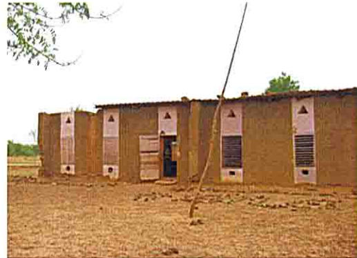
教室棟外観（老朽化が激しい）
