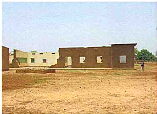
2001年5月に倒壊した校舎
