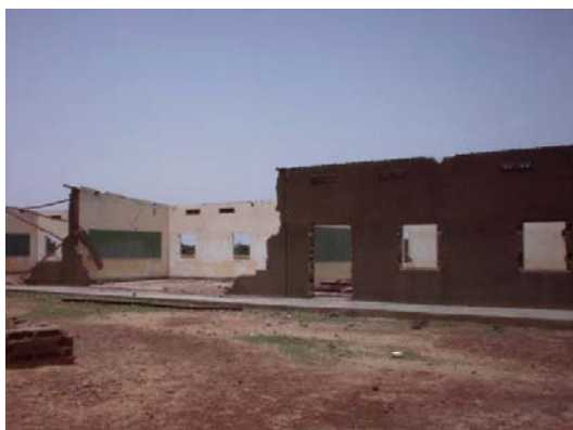
Zondoma 県 Rom 校。施工不良により崩壊した教室棟。
