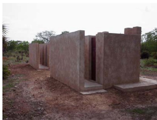
Ziro 県 Tiagau 校。AfD により建設されたトイレ。屋根が設けられていない。
