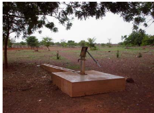
Sanmatenga 県 Gauwa 校の手動ポンプ式井戸。
