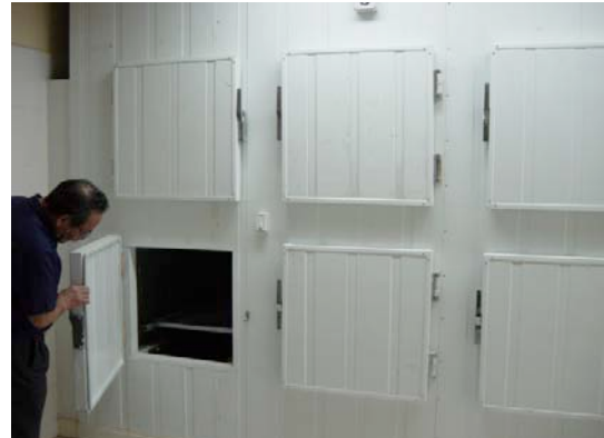
16. BF 死体安置室（設置済みの死体冷蔵庫）
