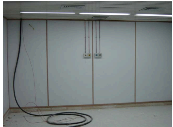
23. GF 放射線部門 (CT室)
