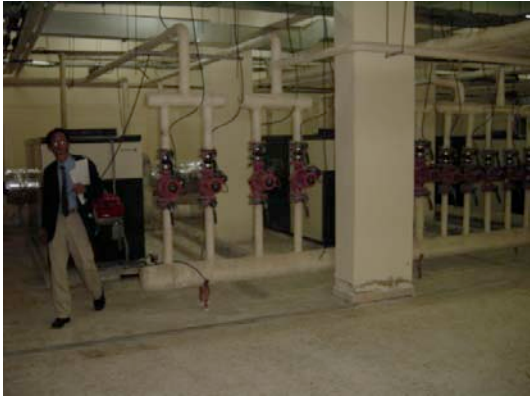
9. BF 中央空調設備
