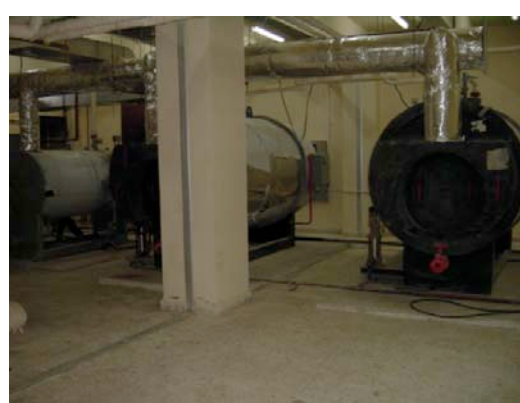
8. BF ボイラー設備
