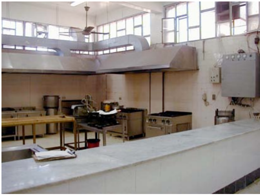
44. ダラア県病院 厨房内の設備
