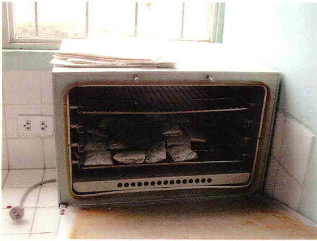
農村保健サブセンター 滅菌器は老朽化している上、容量が小さい。
