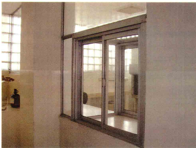
国立衛生熱帯医学研究所 (INH) ワクチン製造棟 衛生環境上、問題がある既存パスボックス
