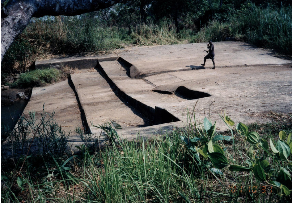
フトン籠をコンクリートで覆った堰
