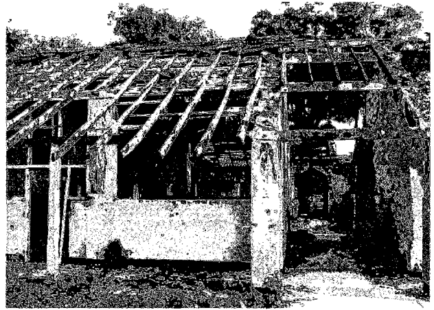
破壊された県病院病棟 (1) (チャワカッチェリ、ジャフナ県)
