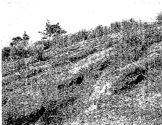
図 10.11 Sta.17.5km 地点でのガリ浸食の様子
