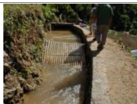
除塵スクリーンとヘッドタンク
