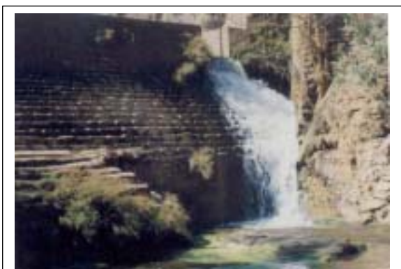
既設構造物の使用例 既設の石積ダムを取水せきとして利用
