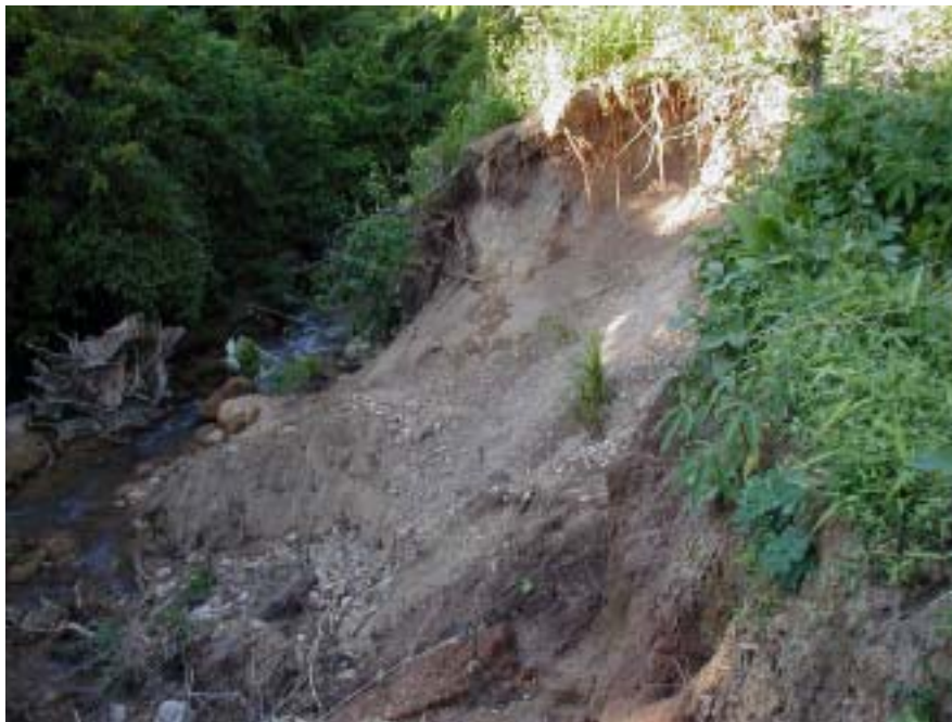
水路越流に起因する斜面侵食による斜面崩壊例
