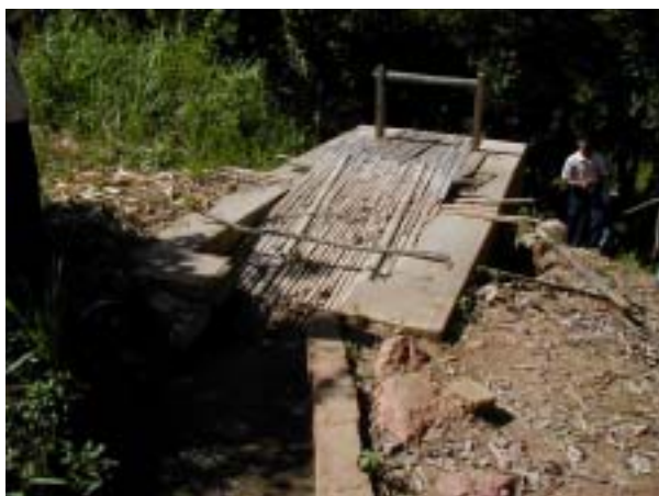
余水吐がなく、側壁の高さが不足している水路
