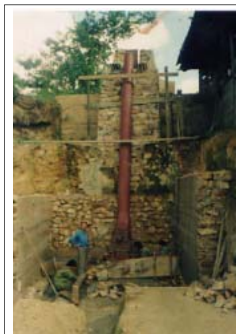
石積み斜面のペンストック 地形に合わせるため、石積みの上に ペンストックが設置されている。 マインボン村
