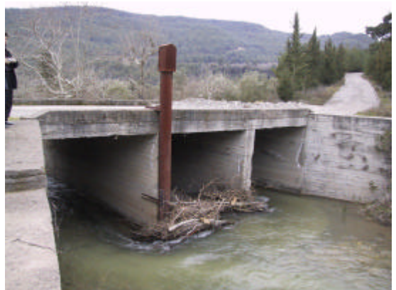
10. 沿岸部流域の既存水位計
