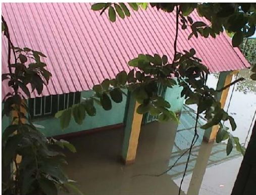
TQ-6 Phan Thiet 雨季には河川が増水し床上に浸水する。
