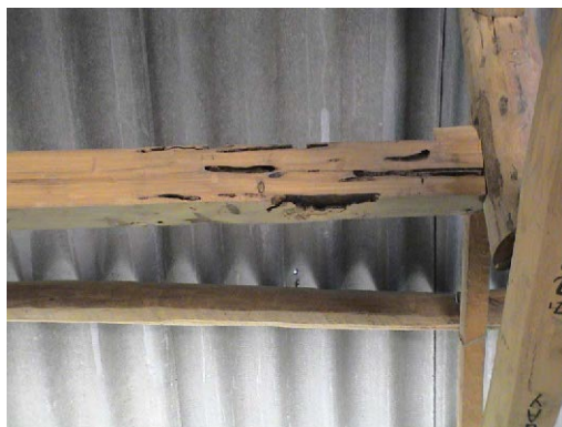
TQ-14 Phuc Thinh 屋根構造体のシロアリ被害
