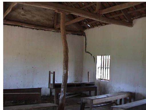
PT-11 Trung Nghia 壁面に入ったクラック
