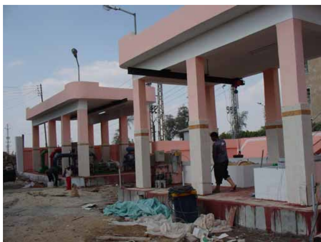
既設ヒヒヤ浄水場 新設簡易浄水施設
