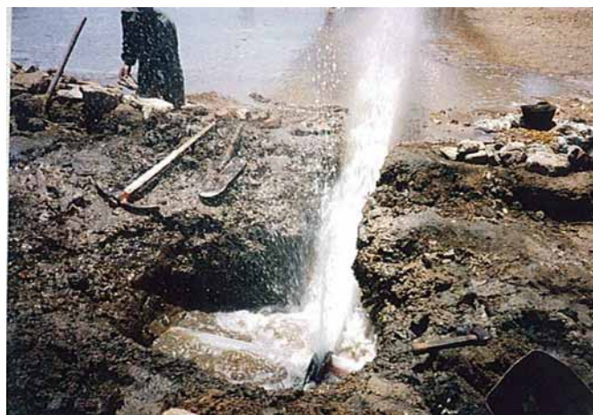
漏水現場 (シャルキーア県ファクス市内)
