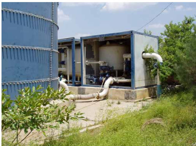
既設コンパクトユニット ヒヒヤ村落部
