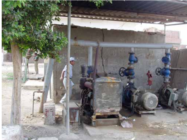
既設井戸ポンプ及び非常用発電機 ヒヒヤ村落部
