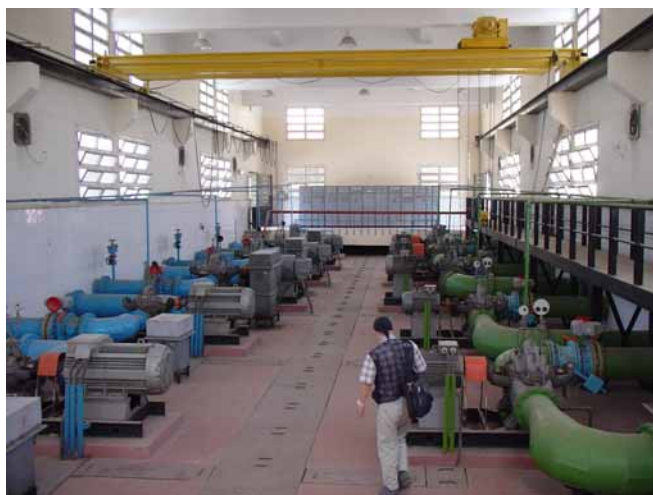
既設ザガジグ浄水場 ポンプハウス (導水ポンプ及び送水ポンプ)
