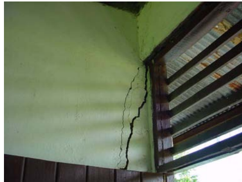
教室棟破損部分詳細
