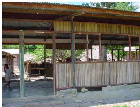
使用不能鉄骨造建物
