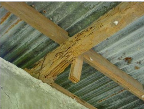
屋根構造材のシロアリ被害
