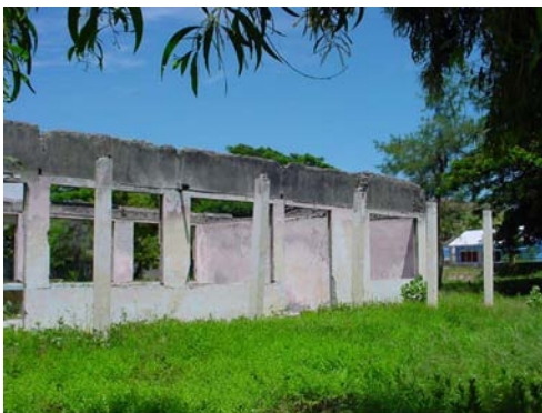
使用不能建物
