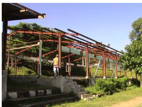
使用不能建物
