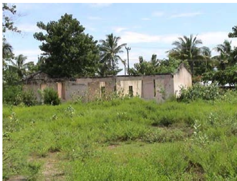
使用不能建物
