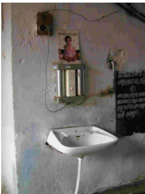
手術室の前室：手洗い 壁面に紫外線滅菌水装置が据付られている。
