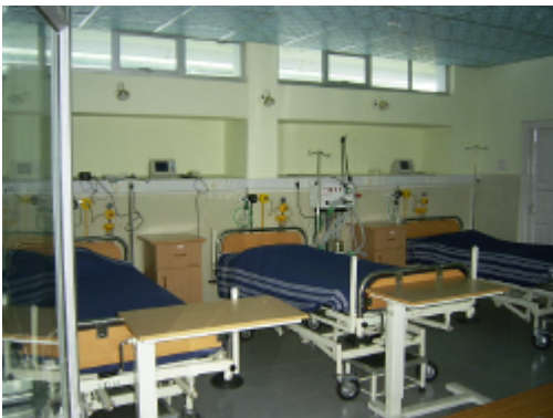
ICU 室：ICU ベッド、人工呼吸器 6床の規模。酸素・空気・吸引の 接続口が壁面に設備されている。
