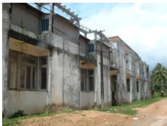
シアヌークビル郵便局、老朽化により MPTC が建替え予定
