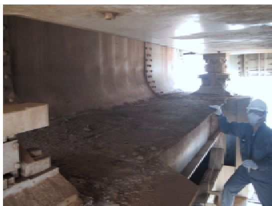
2 径間と 3 径間掛け違い部の錆の発生
