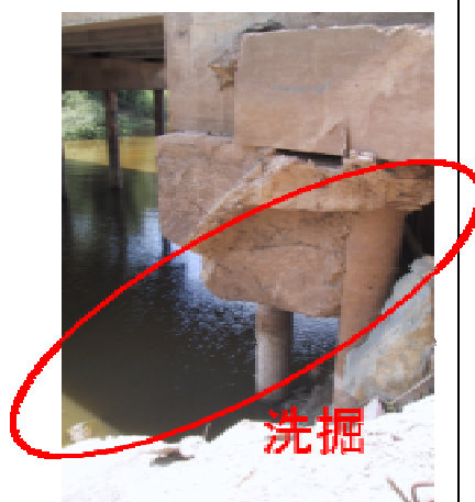
橋脚部、橋台部の洗掘が大きい
