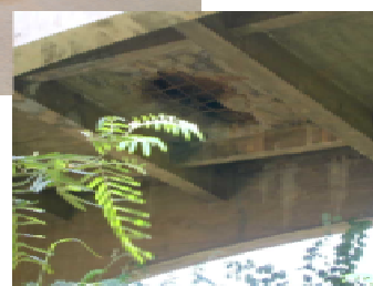
鉄板による床版穴あき部の補強 老朽化、重車両の通過で損傷が著しい
