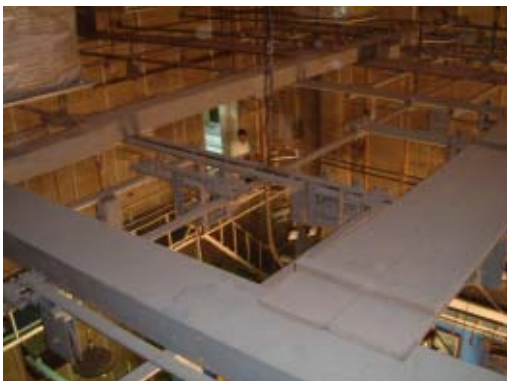
④ パイプ棚とケーブルラック 照明器具を吊り下げる為の鋼管（径50mm）のパイプで格子状に組んだ棚とケーブルラック及び点検歩廊。
