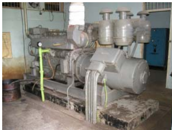
⑩ 既設非常用発電設備
