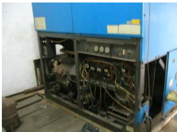
⑨ 既設空調設備
