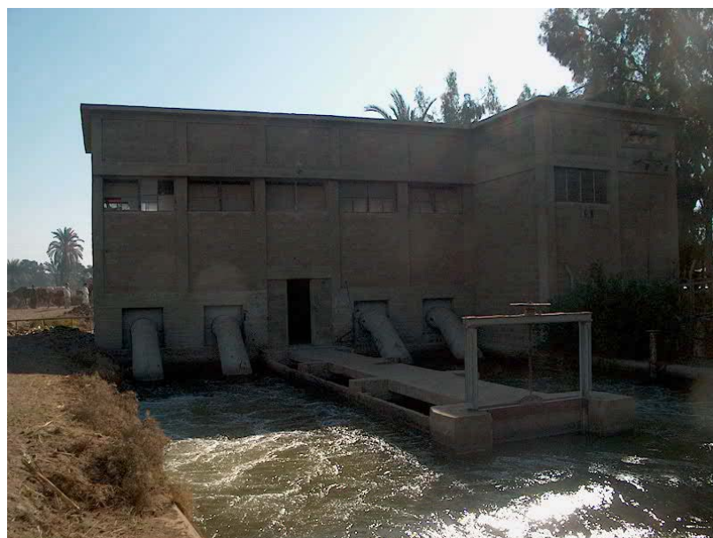
Sakoula No.4 ポンプ場(Old)吐出口側：
