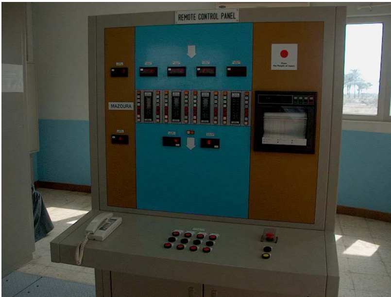
マゾーラ堰管理棟内部の遠方操作パネル：
