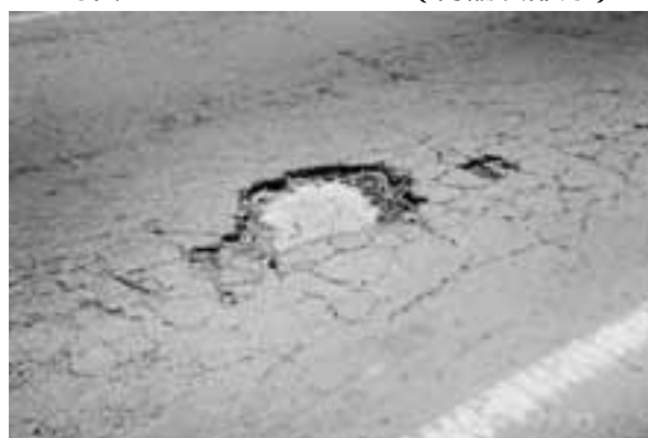
写真2 2 ポットホール（再舗装部分）
