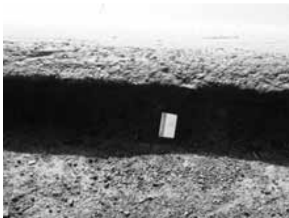
写真 2 9 路肩段差20cm以上 (2)
