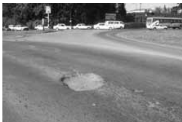
写真2 1 ポットホール
