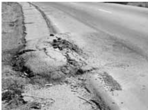
写真 2 10 路肩部分の変形
