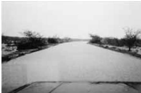
写真 2 35 水没した道路工事現場
