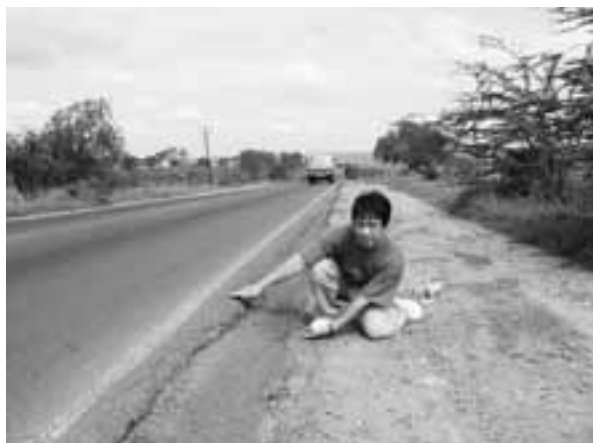
写真 2 8 路肩段差20cm以上 (1)
