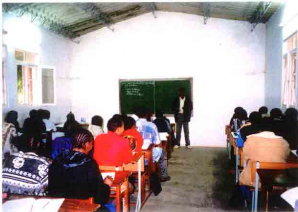
一般教室における授業。天井が無い場合、太陽の輻射熱により室内の気温が高い。さらに小学生用の机・椅子が設置されており、学習に支障がでている。
