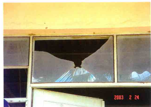
一般教室は既存施設の中でも特に老朽度が高い。窓ガラスが破損し、右側ドアが失われている。ガラスは落下の危険性がある。
