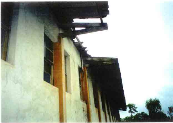
女子学生寮の屋根の状況、既存施設の多くに見られる屋根の老朽化による破損。
