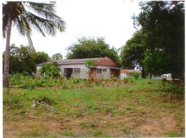
教師・職員用宿舎の外観。屋根は老朽化が著しい。雨漏りが激しいため、使用されていない部屋がある。
