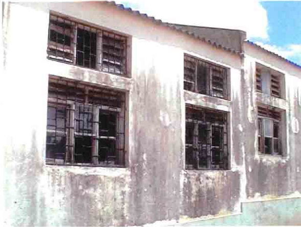
男子学生寮の外観。外壁は汚れ窓は朽ちている。特に防虫網が無い場合、マラリア感染が懸念される。
