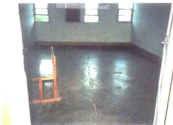
女子学生寮の床に大きな亀裂が見られる。構造体の不同沈下によるもので、危険なため現在は倉庫として使用されている。
