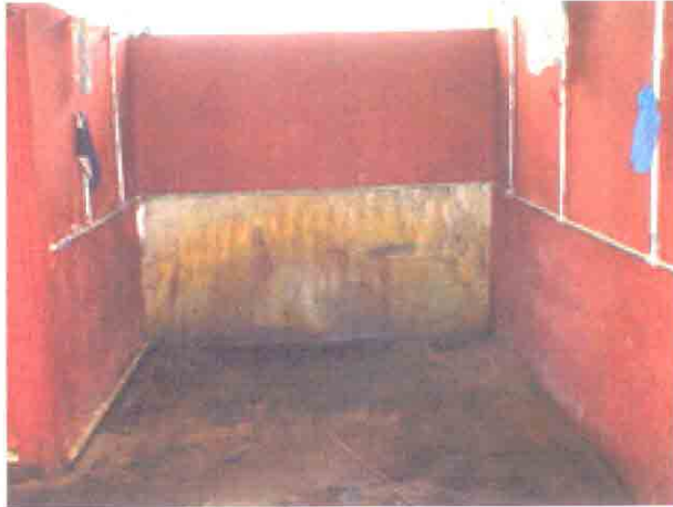
男子学生寮内の小便所兼シャワー室、水の供給状況は悪く、悪臭が充満している。
