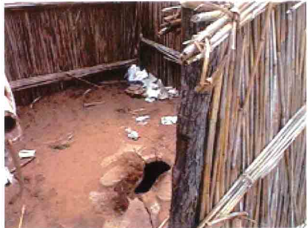
内部の便所の管理状況が悪いため、野外に穴を掘って便所として使用しているが、モルタル便器には多数のひび割れが発生しており、危険な状況にある。
