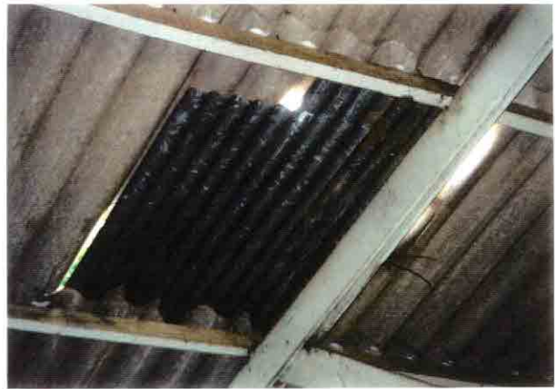
屋根の破損箇所を補修したものであるが、対処方法が適切でないため漏水が続いている。
