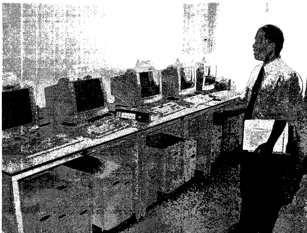
サーバールーム
