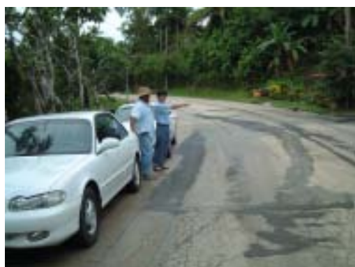
写真 3-1 首都圏道路の舗装劣化
