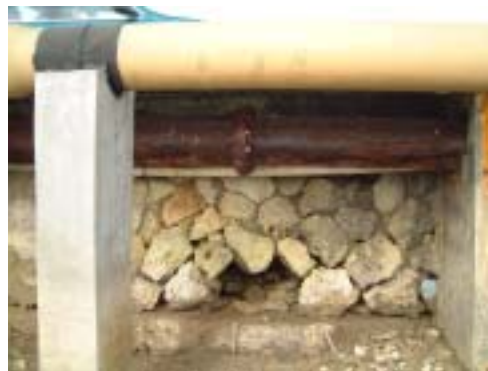
歩道側の壊れている部分。かなり見られる
