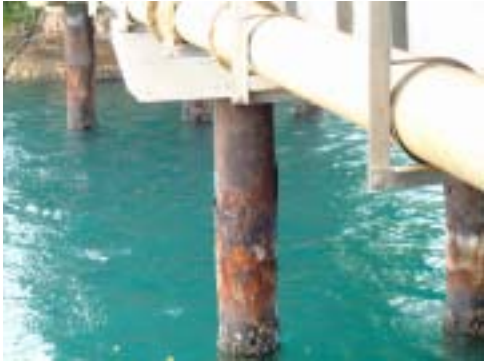
鉄管部分が完全に腐食している。一方、上部工は構造物として健全性を保っている。
