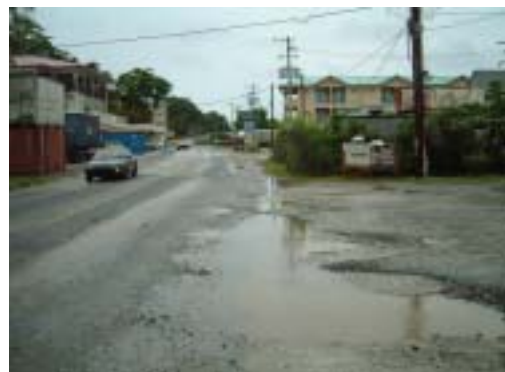
側溝がないために、雨水が道路上を冠水している。舗装も端部が破壊されている。
