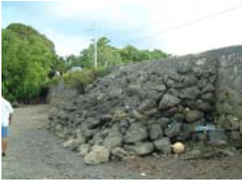
3ヶ月前に仮補強された部分
