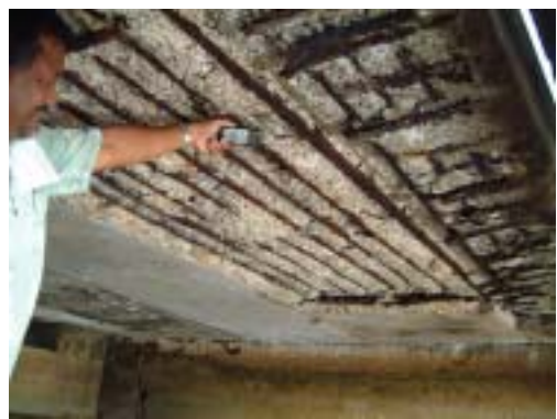
カルバートの上部コンクリートが完全に剥離している。
