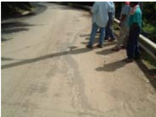
地すべり区間。道路は沈下している。道路内部には上水管、下水管が埋設されている。
