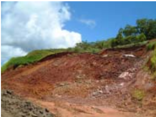
コンパクト道路での典型的な斜面崩壊箇所。
