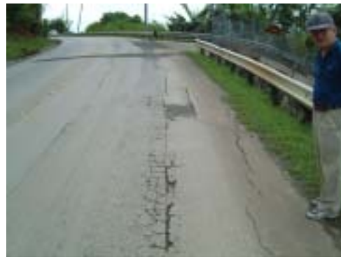
アラカベサン区間の地すべり箇所、ガードレールが傾いている。また、上水道、下水道管が埋設されている。
