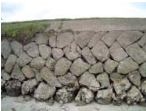
コースウェイの下部が洗掘、侵食されている。
