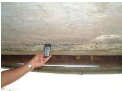
カルバートの特定部分が破壊、沈下している。
