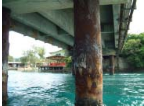
完全に腐食した鉄管部分。
