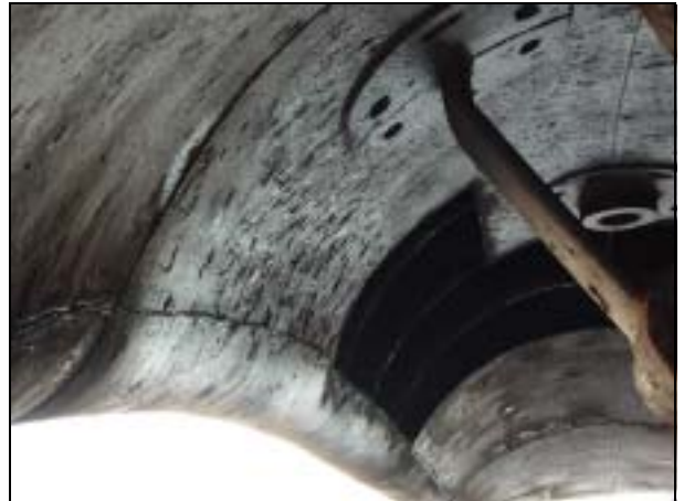
写真 16 シャフトトンネル外板部発錆箇所
