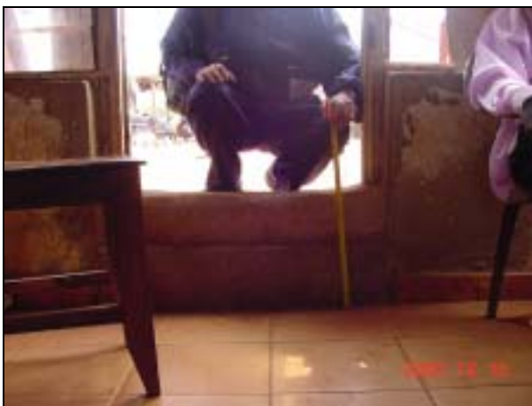
写真 41 エリテンダ管理事務所の地盤沈下(14年間で約350mmの沈下)
