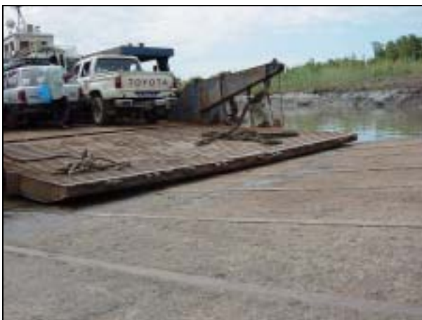
写真 5 大型車輛により損傷を受けたランプドア
