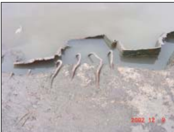
写真 47 コンクリート部が破損し矢板・鉄筋が船底と接触し損傷
