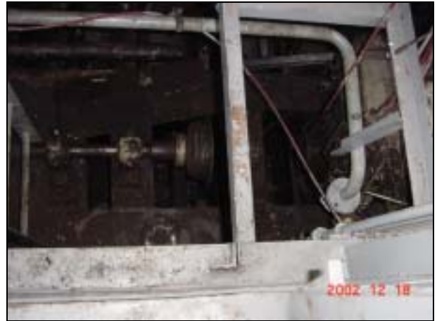
写真 28 上から見た左舷側の主機関台
