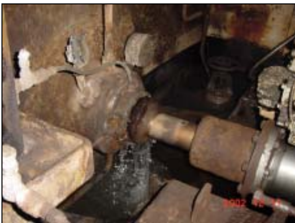
写真 11 プロペラ軸スタンチューブシール装置部の損傷による漏水(4箇所とも漏水発生)
