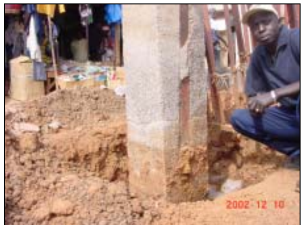
写真 42 エリテンダ管理事務所の地盤沈下
