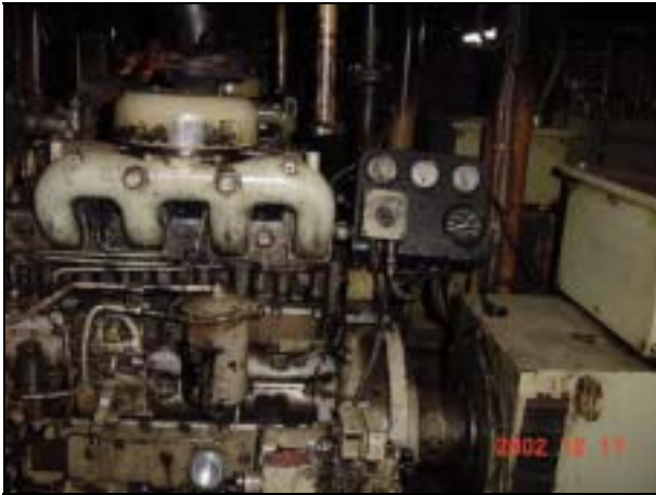
写真 9 主発電機機関、計器類及び安全装置の状況
