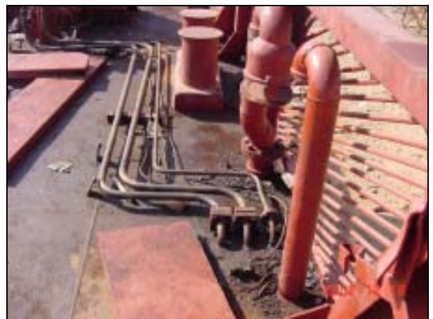
写真 30 ランプドア用高圧油圧パイプ
