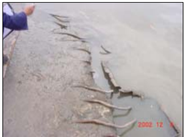
写真 48 広範囲にわたり矢板・鉄筋が損傷
