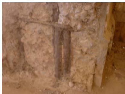
教室棟躯体破損
