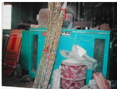
発電機 (倉庫内)
