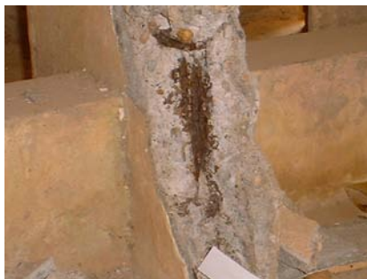
教室棟鉄筋腐食
