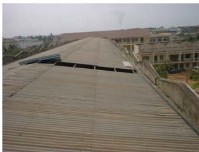
教室棟屋根破損
