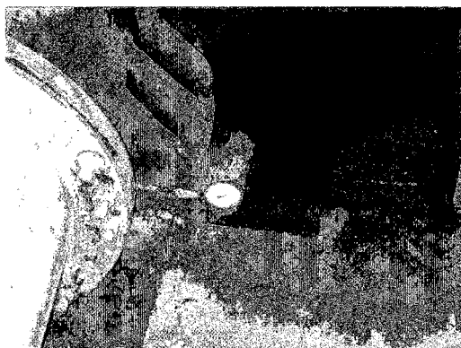
ポンプに設置されている圧力計 吐き出し側のみで吸い込み側には設置されていない。
