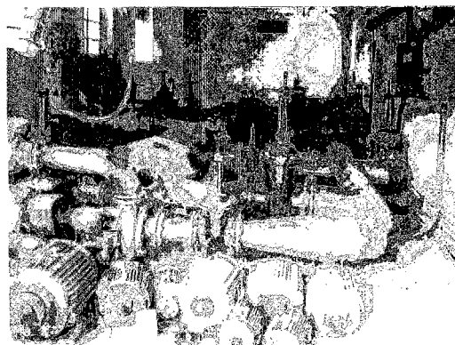
配水ポンプ場
