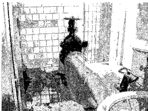
水中ポンプに設置されているバルブ
