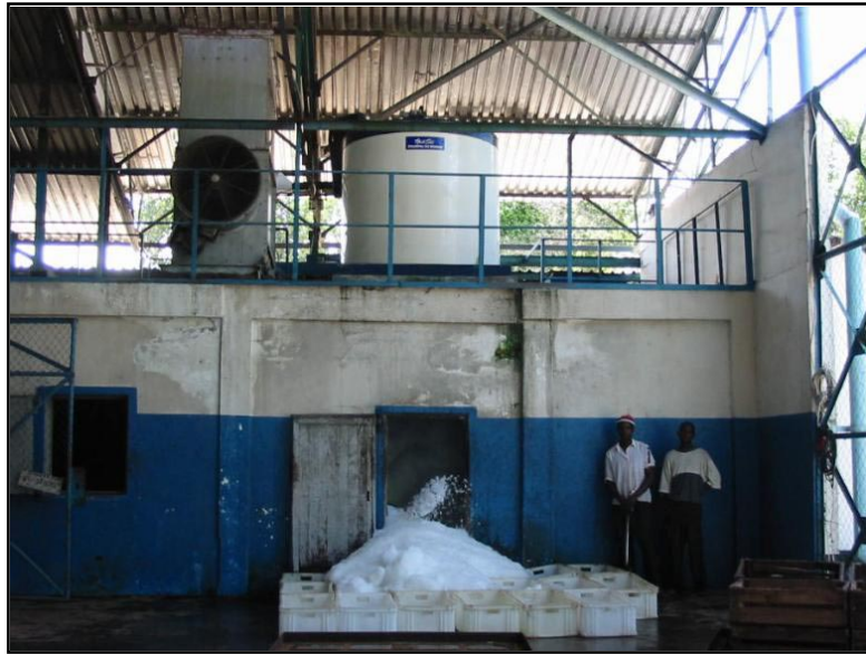
民間漁業会社( MALDECO 社 ) 世界銀行のローンで設置された製氷施設
