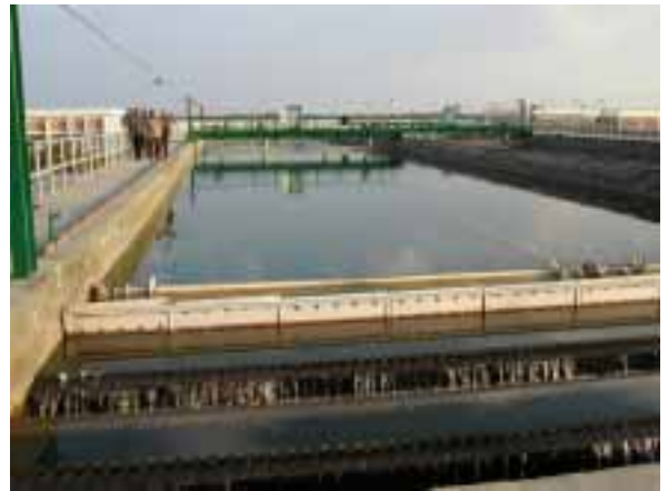
写真 11 : Faqus 浄水場、沈殿池
