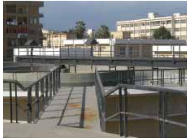
写真 4 : ZAGAZIG 浄水場 沈殿地 (増設)
