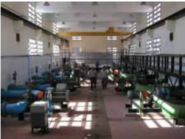
写真 3 : ZAGAZIG 浄水場 原水取水・浄水送水ポンプ
