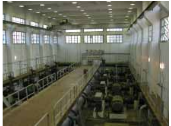
写真 10 : Faqus 浄水場：原水・浄水ポンプ機場
