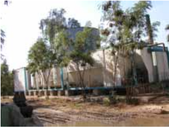
写真 13 : Hihya 市、コンパクトユニット
