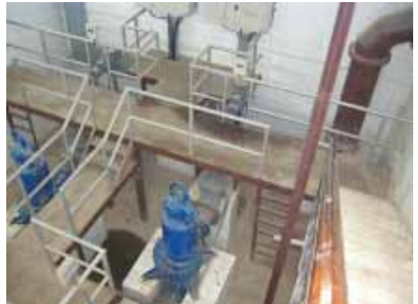
写真 12 : Faqus 浄水場、スラッジ排出ポンプ
