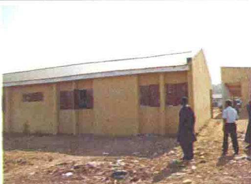
新築校舎裏側 (屋根の軒先や棟の歪みがある)
