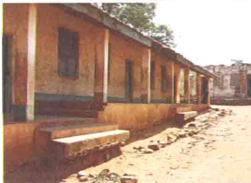
外廊下 (土壌が流出したため、基礎底部が露出)
