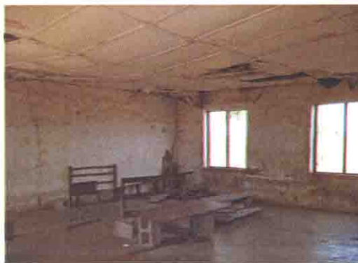
教室内部（天井が垂れ下がっている）
