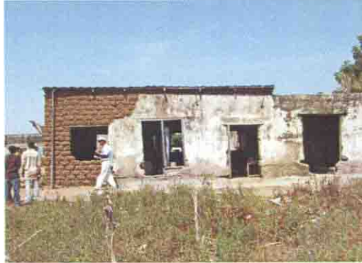
教室として使用中のかなりひどい建物
