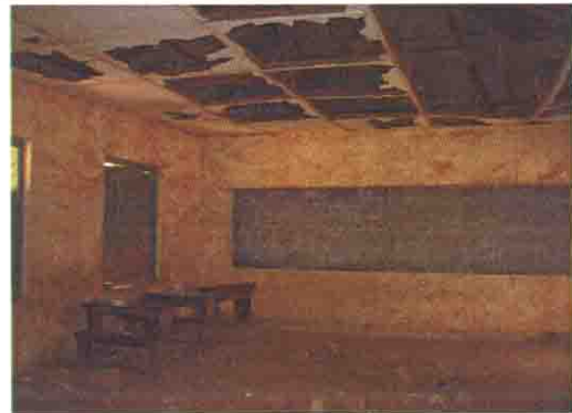
教室内部 (床、天井ともに傷みが激しい)
