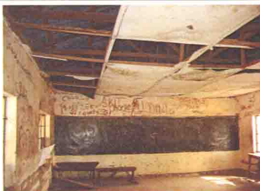
教室内部 (天井が垂れ下がっている)
