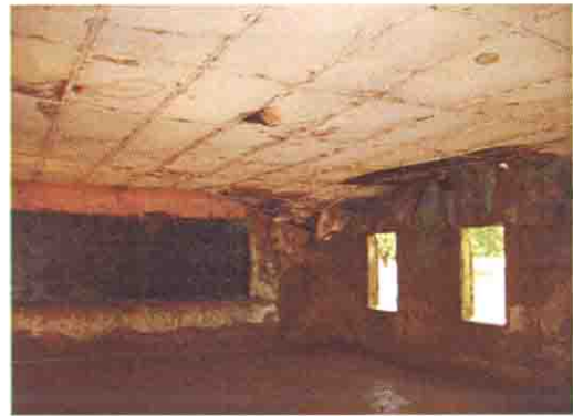
教室内部（壁が、かなり傷んでいる）
