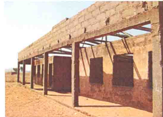
1996年ごろ、建設が中断された校舎
