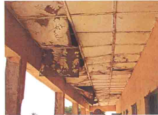
傷んだ外廊下の天井仕上げ材
