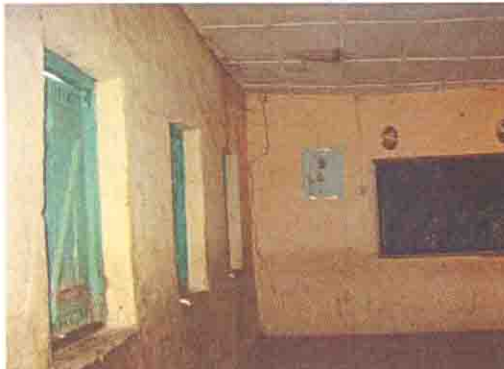
教室内部 (壁が外側に傾いている)
