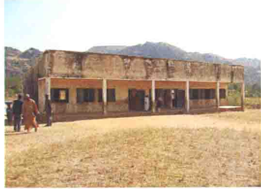
痛みの激しい校舎 (1990年建設)
