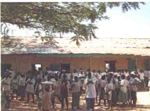
かなり痛みの激しい校舎の屋根、壁
