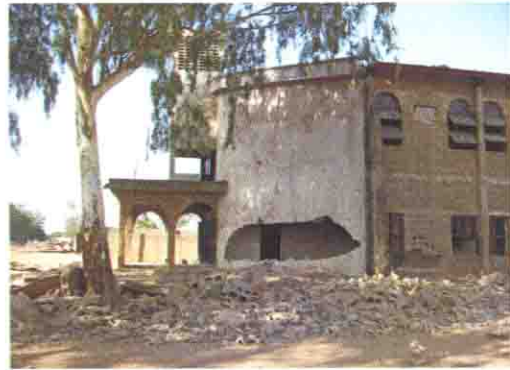
11月下旬の暴動で破壊された教会
