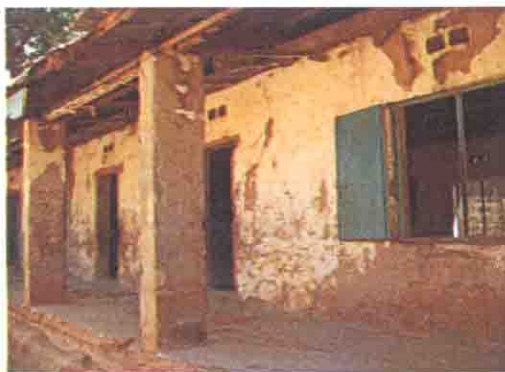
かなり傷みの激しい外廊下
