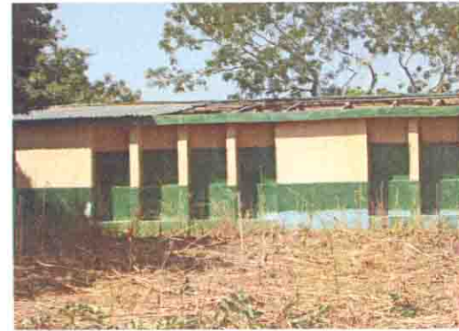
強風で吹き飛ばされた屋根 (2001年、UBEにより新築)
