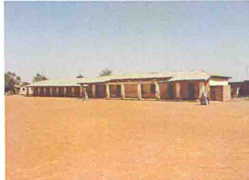
既存校舎の全景 (損傷が激しい外廊下屋根)
