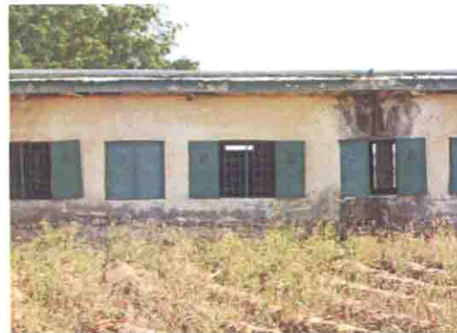
雨漏りにより傷んだ外壁
