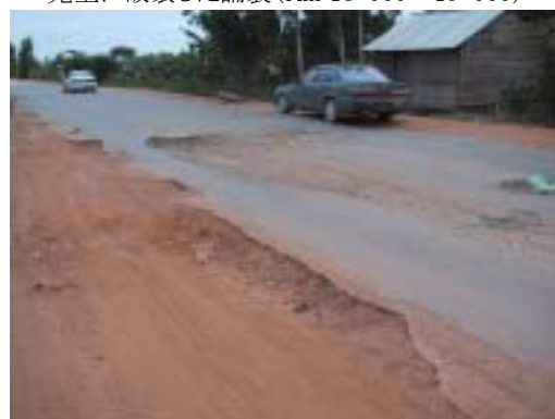
拡大したポットホールと舗装端部の破損
