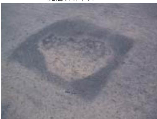
ポットホールを補修した箇所;すでにクラックが発生
