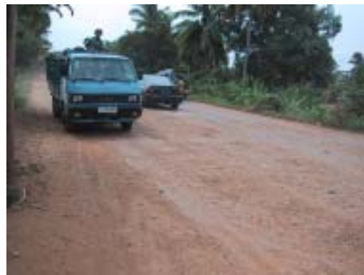
完全に破壊した舗装 (Km 18+000~19+000)
