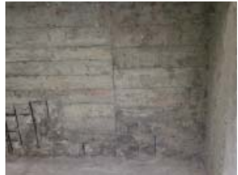
番号 13. Km 50+040 Kampong Phnom Water Gate 床版下面：剥げ落ち、露出した鉄筋、コンクリートによる補修跡が確認できる。
