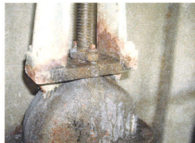
⑤ 吐出弁 パッキンの漏水と腐食
