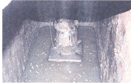
④ フート弁 動作不良あり
