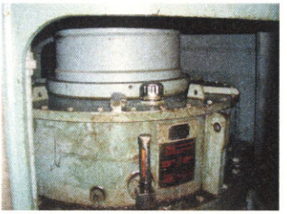
① 主ポンプ 軸受の振動が大きい
