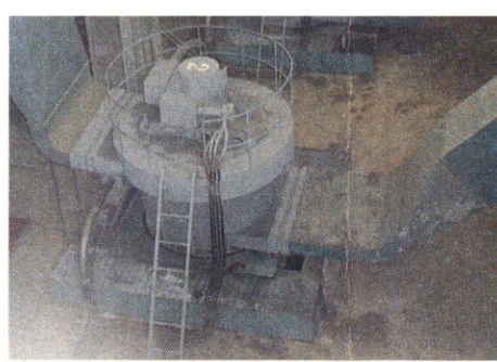
② 電動機 焼損履歴がある
