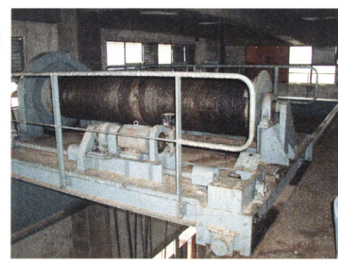
⑪ 天井クレーン ギヤボックスに鳥類営巣
