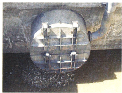
⑩ フラップ弁 弁体に発錆あり
