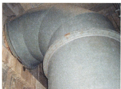
⑥ 配管 部分的な発錆あり
