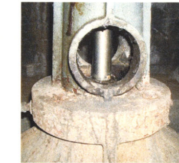
⑤ 吸込弁 パッキンからの 漏水による発錆
