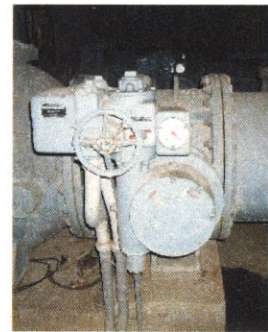
⑧ 電動吐出弁 駆動部・送信器 の点検を要する
