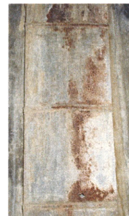
⑦ 換気ダクト 腐食孔 からの空気漏れ
