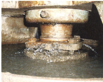
① 主ポンプ 軸封部の漏水
