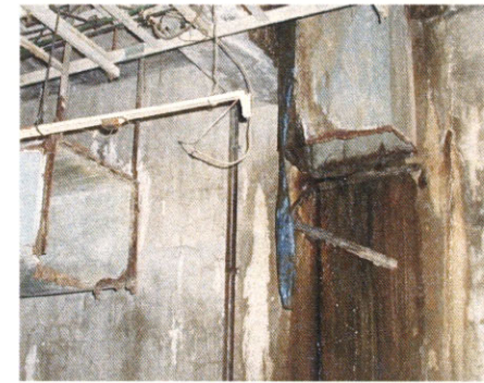
⑦ 換気ダクト 腐食して抜け落ちている
