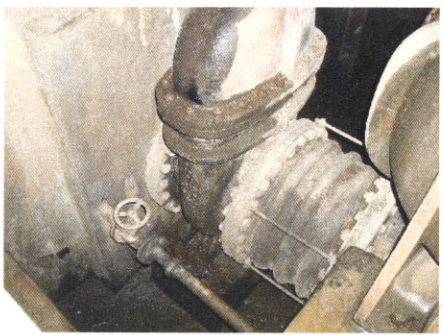
⑤ 吸込弁 パッキンから漏水している
