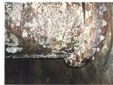
⑥ 配管 漏水により発錆
