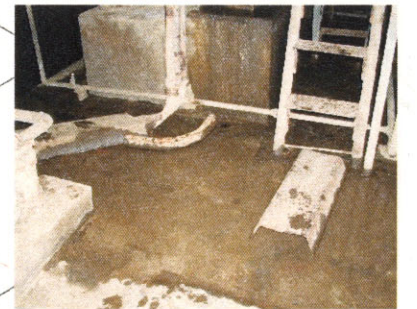
⑩ 配線 床上で浸水している
