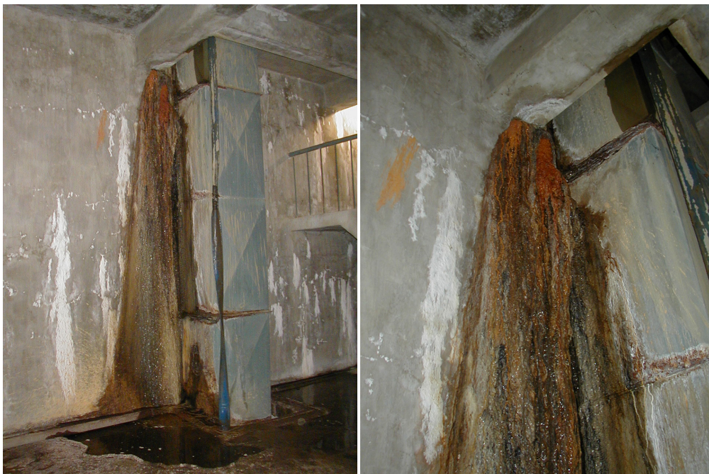
梁と壁の付け根あたりからの漏水。両ポンプ場とも漏水が見られる。
