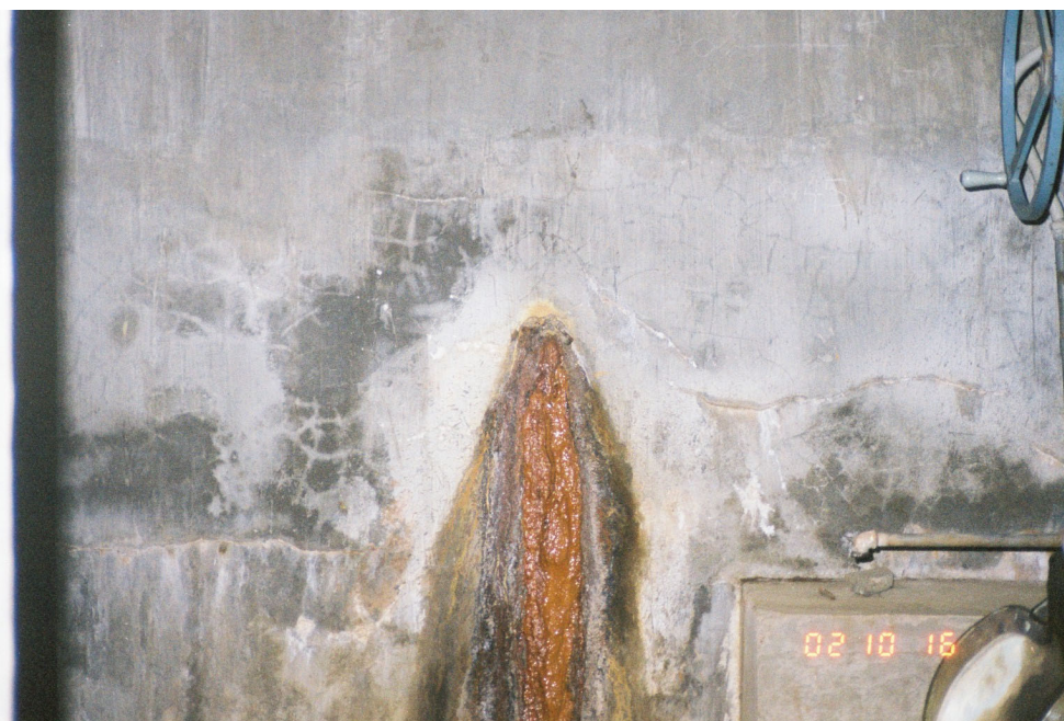
壁からの漏水状況。
