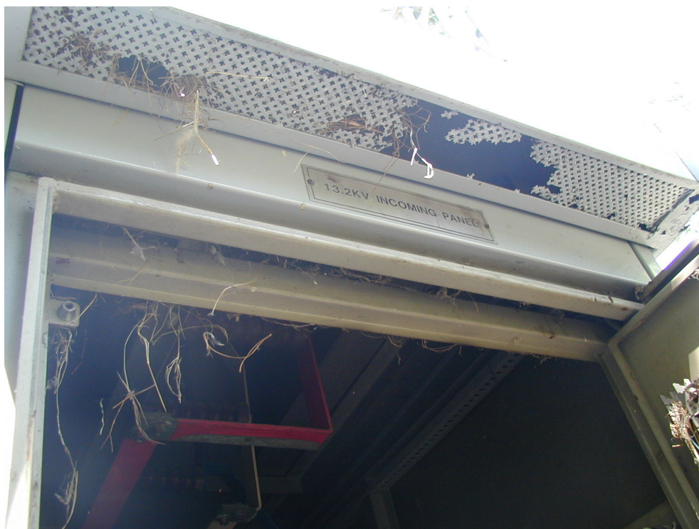
13.2kV 受電盤 通気口の鋼板が腐食、鳥類が内部に侵入・営巣し機器を汚損。
