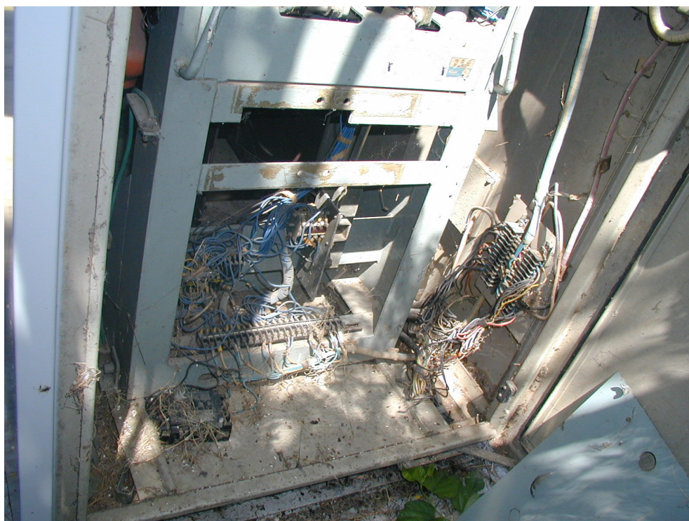
13.2kV 受電盤 下部の端子・端子台に塵埃の付着・発錆あり、配線の汚れが顕著。
