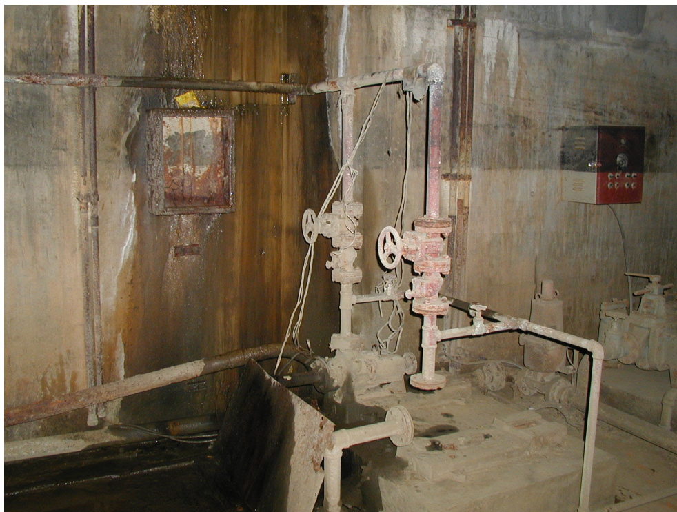
封水ポンプ ポンプ・電動機は損傷のため撤去されている。
