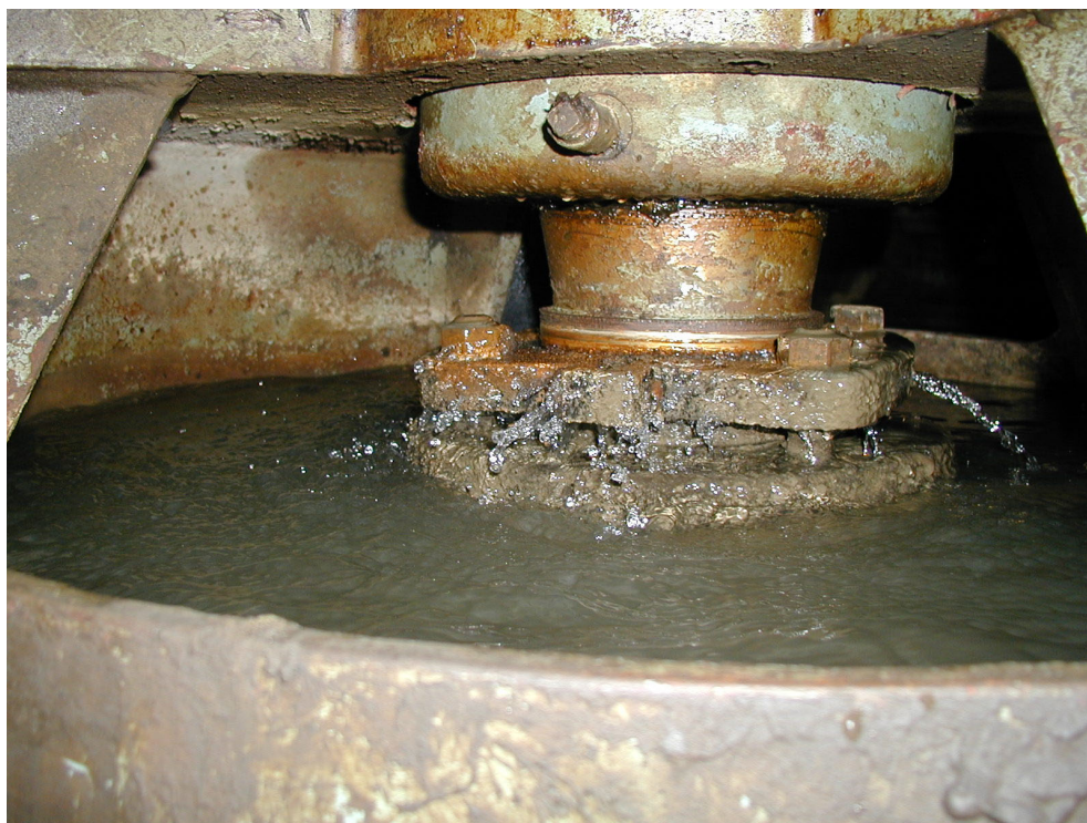
主ポンプ軸封部 スリーブが磨耗、グラウンドパッキンから過剰な漏水あり。
