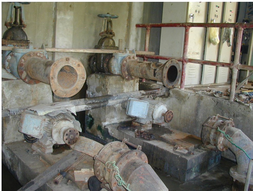
ポンプ場内部 ポンプ2台を取り外し修理中、吐出弁パッキンから漏水あり。
