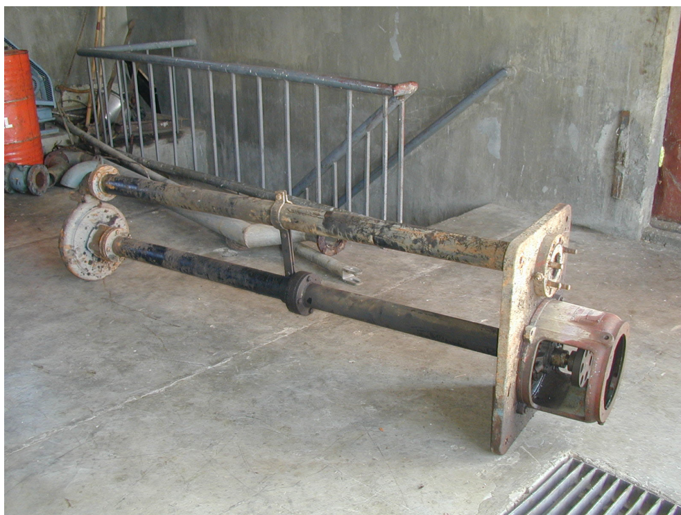
場内排水ポンプ インペラ軸筒部に亀裂あり、中間軸受が磨耗し振動が大きい。
