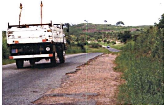
路面状況 (STA23.00 k m)
