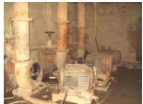
Nam Trung ポンプ場ポンプ内部
