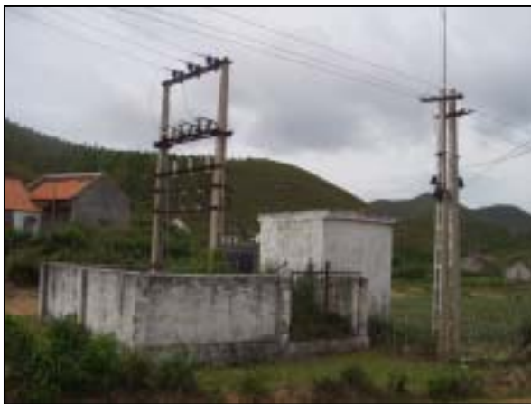
・農村電化 : 既存変電所(Nam Kim Sub Station 3)
