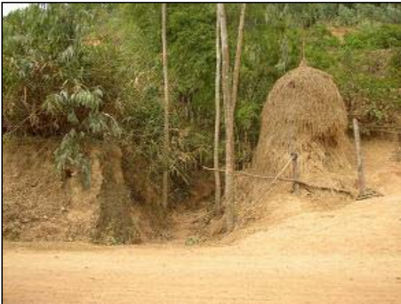
・国道 15A : ガリ侵食部
