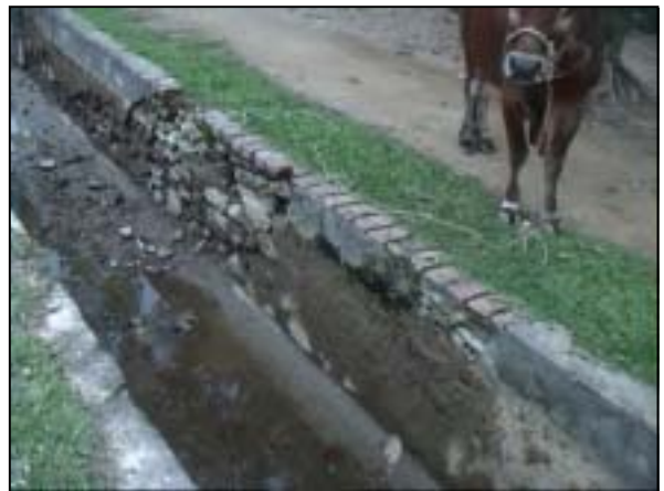
・Nam Trung ポンプ場灌漑システム水路：損壊しているライニング水路（上流側）
